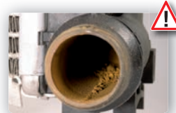
Rost im Kühler
