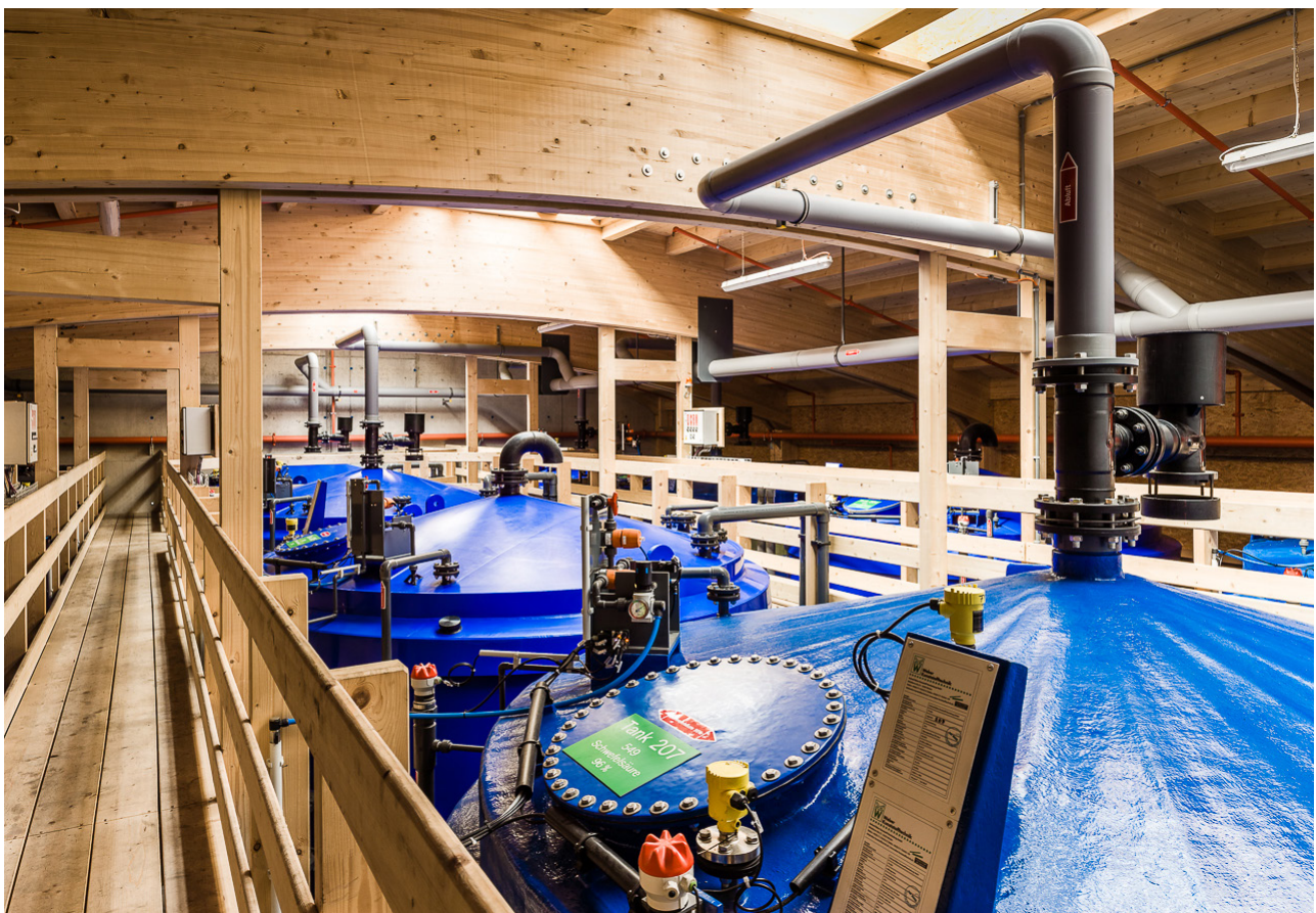
Tanklager mit OptiTank®-Tanklagerbewirtschaftung
